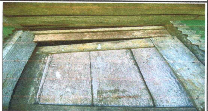
Foto 2: puerta en mal estado se encuentra ya deteriorada por el tiempo
